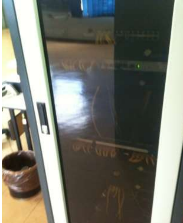
Rack do servidor de rede
