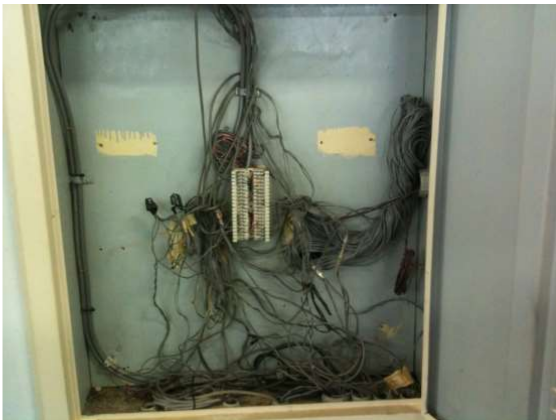
Quadro de telefonia – necessidade de adequação
