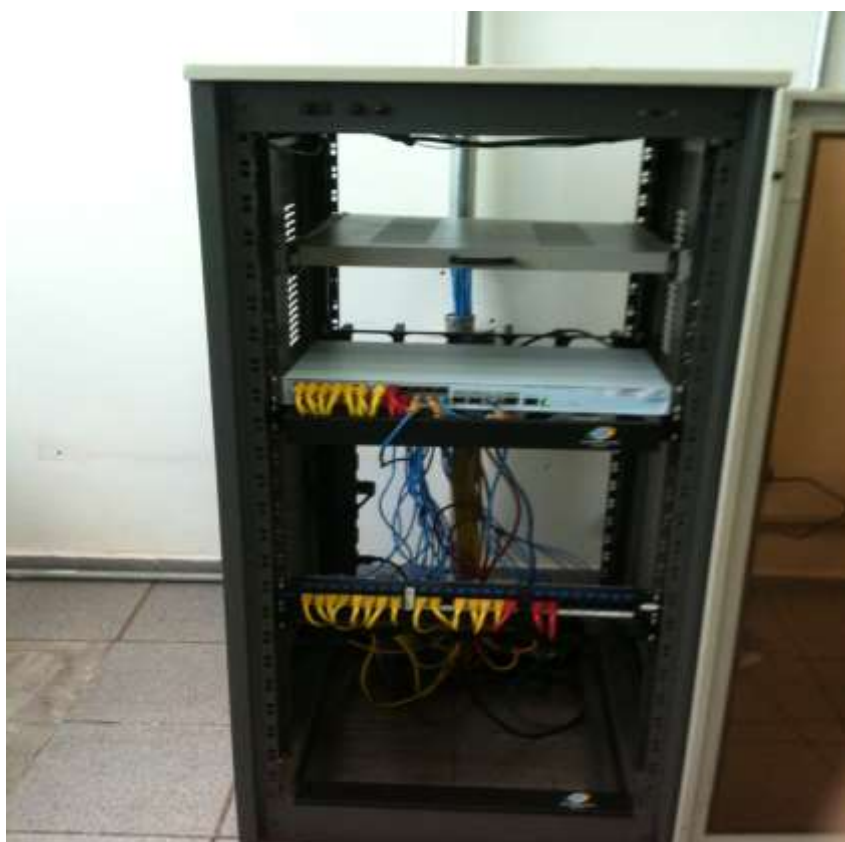
RACK DE SWITCHS - INSS
