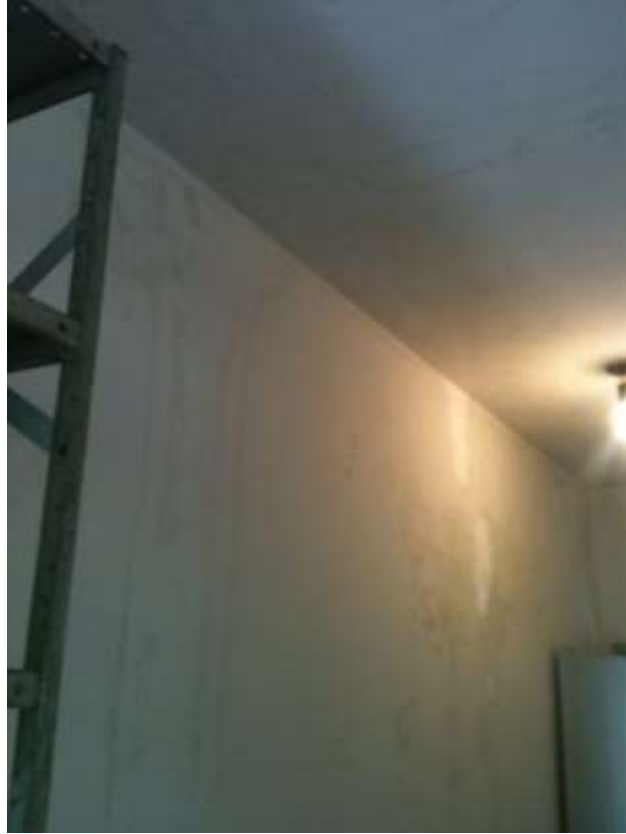
Sinais de umidade no teto e forro
