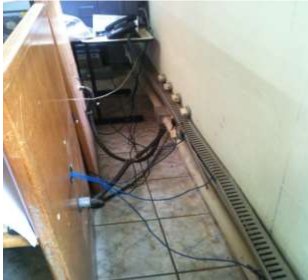
Necessidade de adequações nas redes elétricas e de lógica
