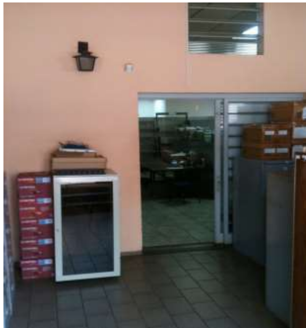
Rack de switches e acesso à área administrativa
