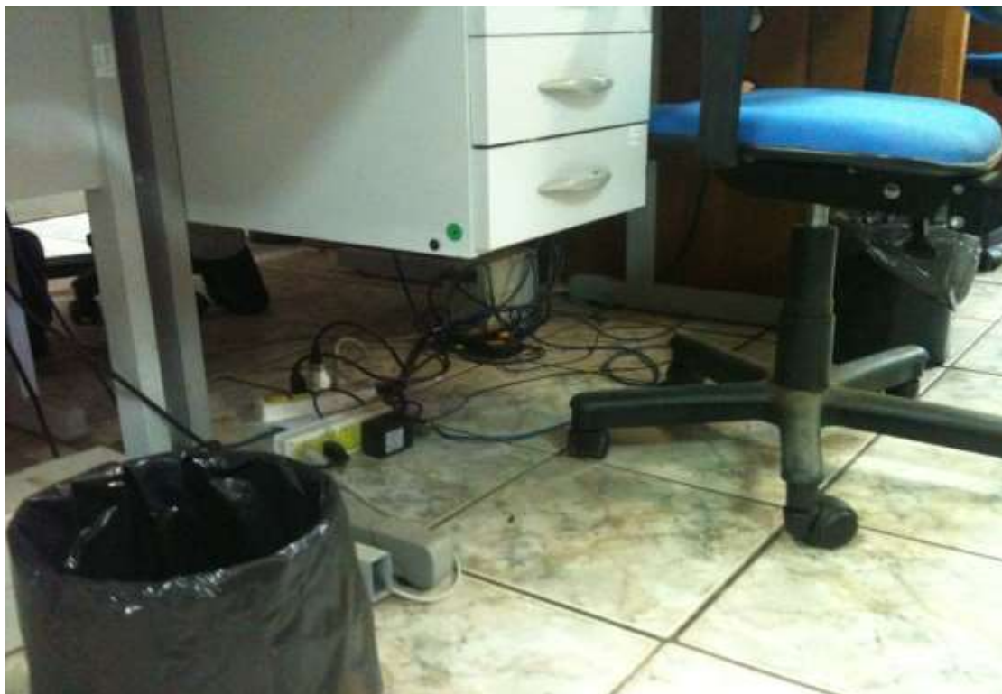
Falta de tomadas elétricas e de lógica
